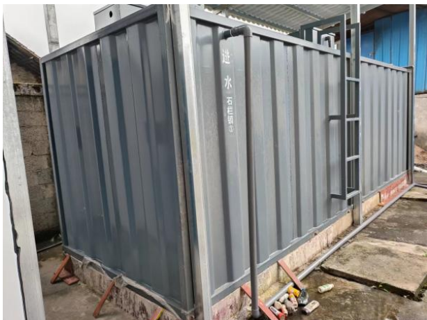
一体化污水处理设施
